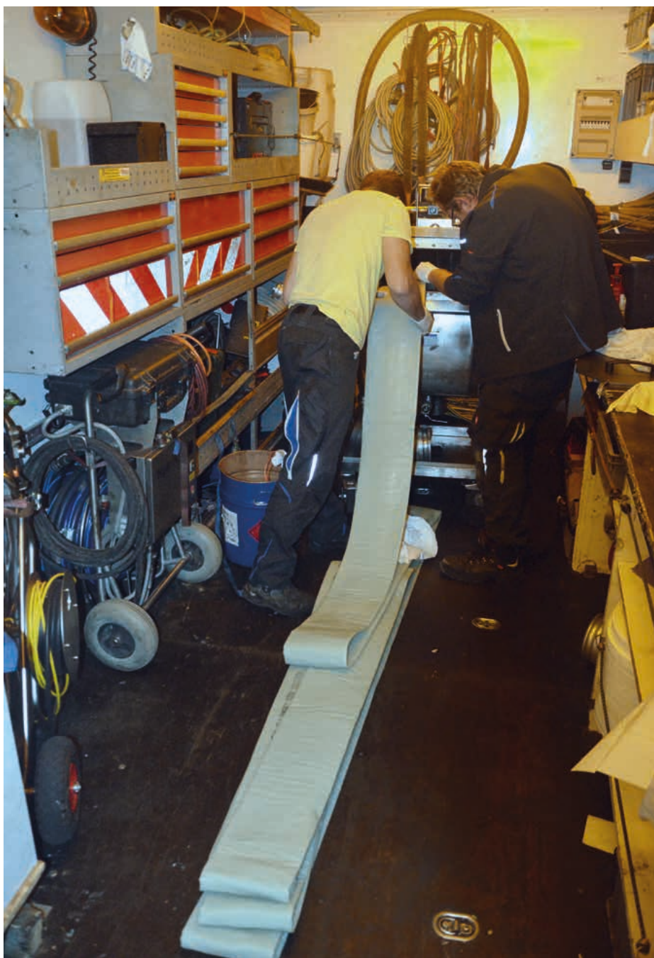
Auftrommeln des vorkonfektionierten Liners. Im nächsten Schritt wird der Schlauch mit Druckluft in die zu sanierende Leitung invertiert | Fotos: A. zu Eulenburg
